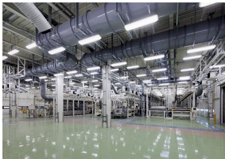
新設しためっき設備
