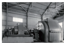
短絡試験用発電機 (1号機)
