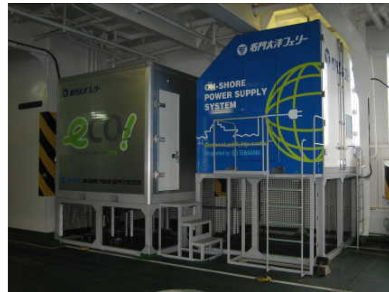
陸電供給システム (AMP,固定型)
