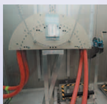
Cable hoisting device ケーブル昇降装置
